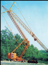
La gru Dalbe 1626 (1974) è stata progettata per effettuare il montaggio e la movimentazione con angoli e forze unici. Disponeva di un intelligente accorgimento: il tratto della fune impiegata per il montaggio della gru non era interessato dalla movimentazione dei carichi, evitando così attenti e scarsi inutili al sistema di cerniere.
